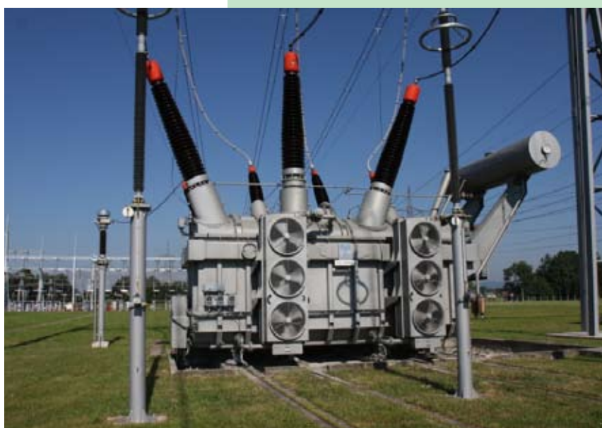
Transformator, ki pretvarja visoko napetost.
