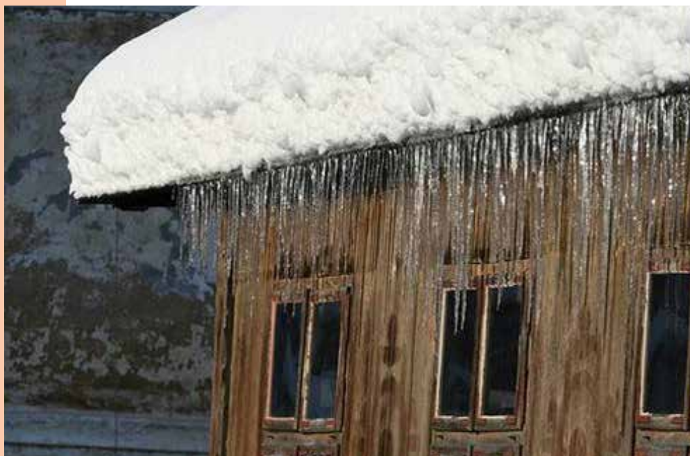
SLIKA 9: LEDENE SVEČE POKAŽEJO OGROMNE TOPLOTNE IZGUBE STAVBE, KI SO NEPOTREBNE. VELJA TUDI NASPROTNO. DOBRA TOPLOTNA IZOLACIJA STAVBE JE POGOJ ZA URE. VIR: HTTP://1.BP.BLOGSPOT.COM/-CQ1ZBFU11MA/UTSSAZGWZHI/AAAAAAAAAJE/HNEOMJNLOMA/S1600/SLIKA4.JPG
