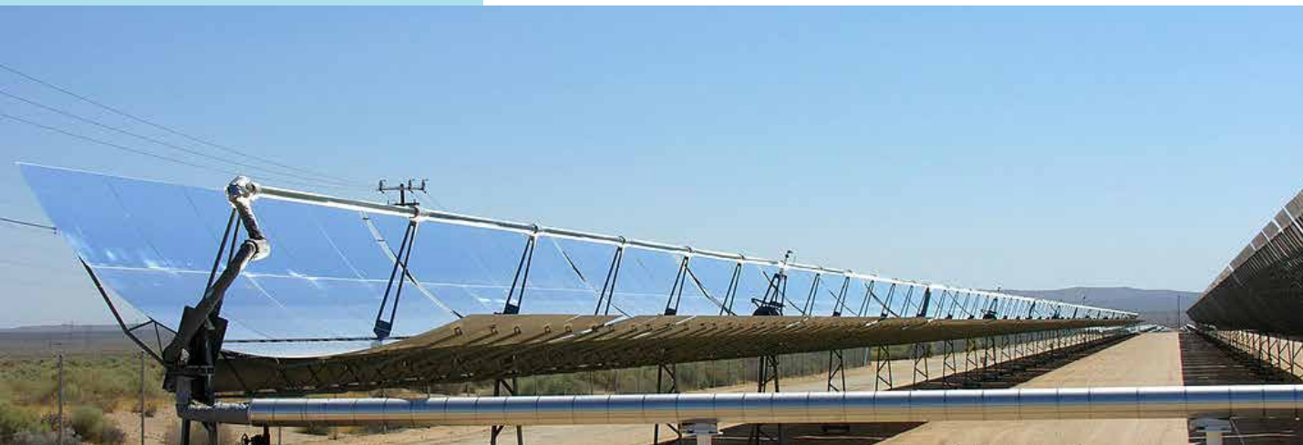
Sončna elektrarna v Kaliforniji
